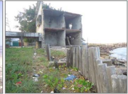
Figura 6 -Erosão costeira na Marginal da Beira. 2012.
