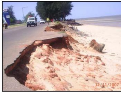
Figura 4 -Erosão costeira na Marginal de Maputo. 2007.
