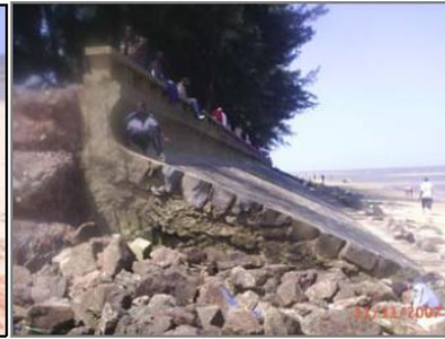
Figura 5 -Erosão costeira na Marginal de Maputo. 2007.
