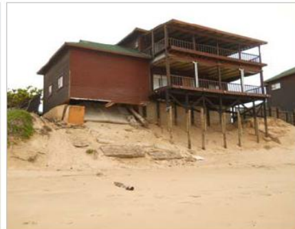
Figura 8: Efeitos da erosão costeira nas construções feitas na área de protecção parcial. Ponta de Ouro.
