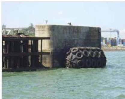
Figura 24: Incidente num terminal: Navio Ratna Shalini. Porto de Mombasa. Quênia.
